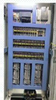
楼层控制电箱
