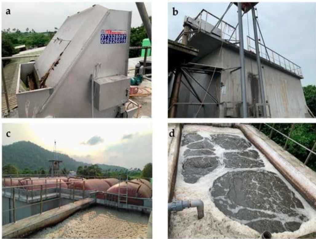
某猪舍废水处理系统外观
