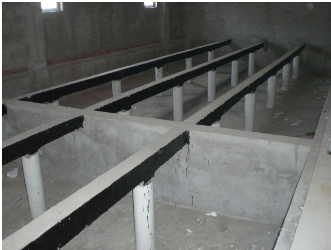
水泡粪工艺（粪沟变浅）
